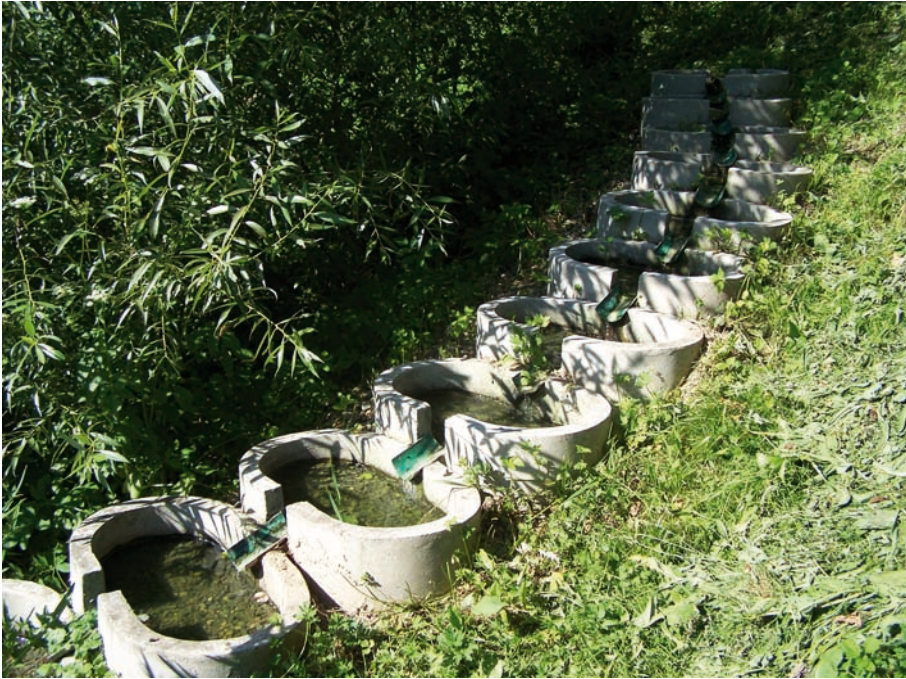
Kaskadowe napowietrzanie ścieków
